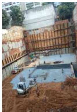
Vista general de la obra con la instalación del Sanifos 2100.
