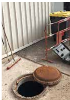
Sanifos 1600 instalado al lado del edificio.
