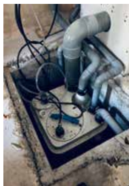
Sanicubic 1 WP instalado en el sótano.
