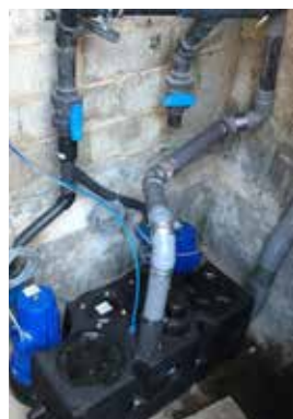
Sanicubic 2 GR instalado en lugar de la antigua estación.
