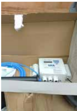
Cuadro de control.
